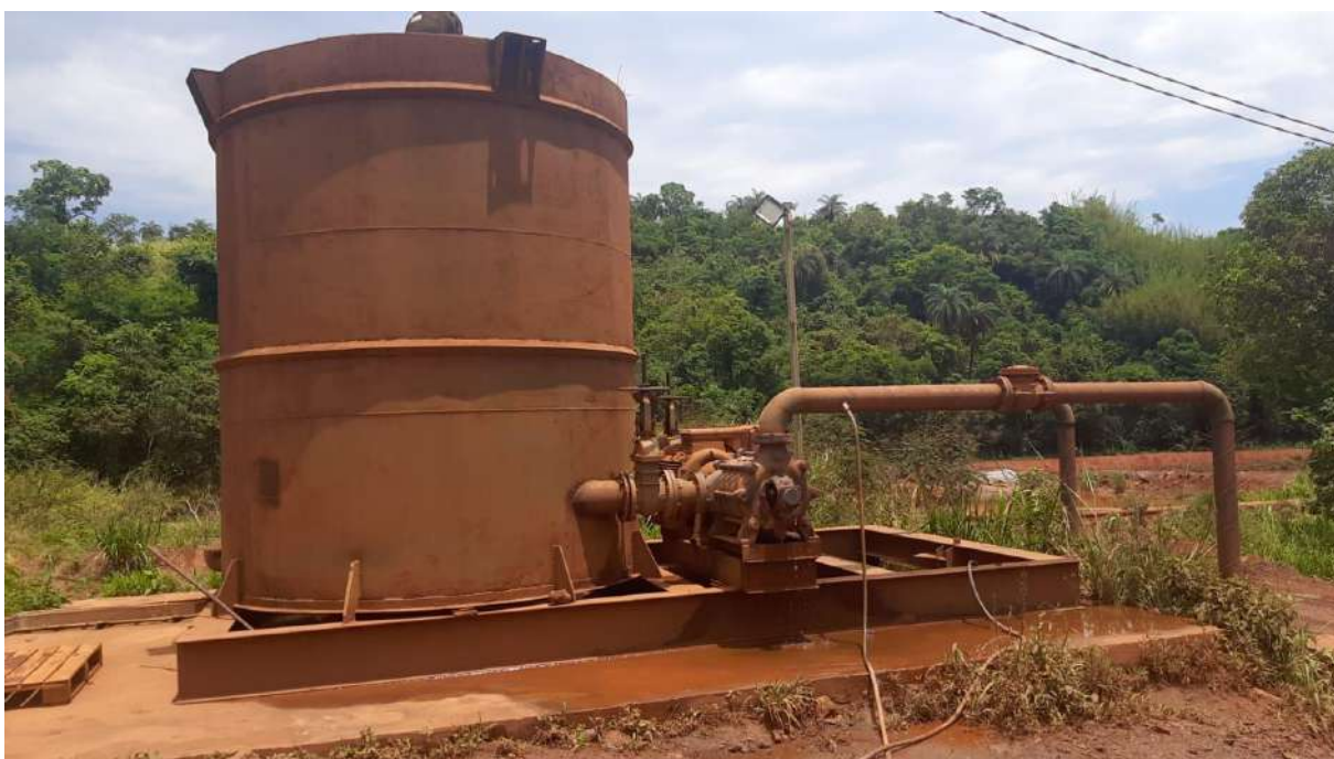
Foto 6 - Estação de bombeamento
