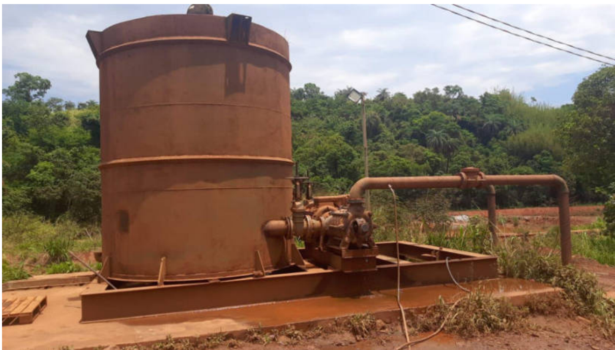
Foto 6 - Estação de bombeamento
