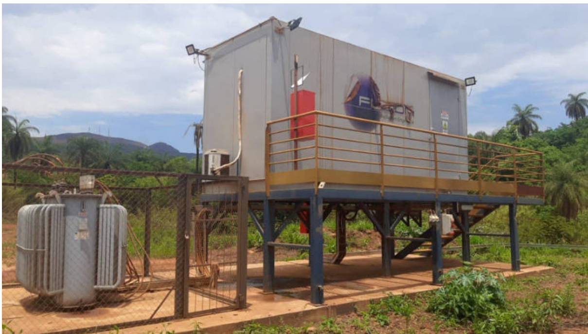
Foto 5 – Central de energia e automação do sistema de bombeamento
