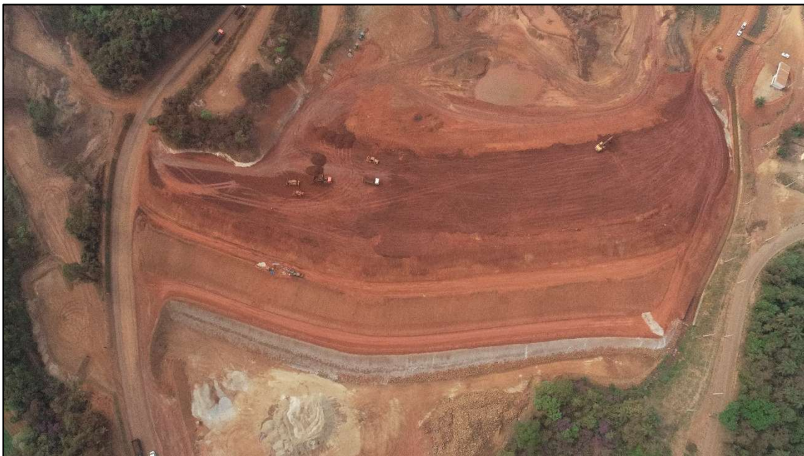
Foto 06 – Vista superior da estrutura, notar avanço no aterro controlado. Registro em setembro de 2022.
