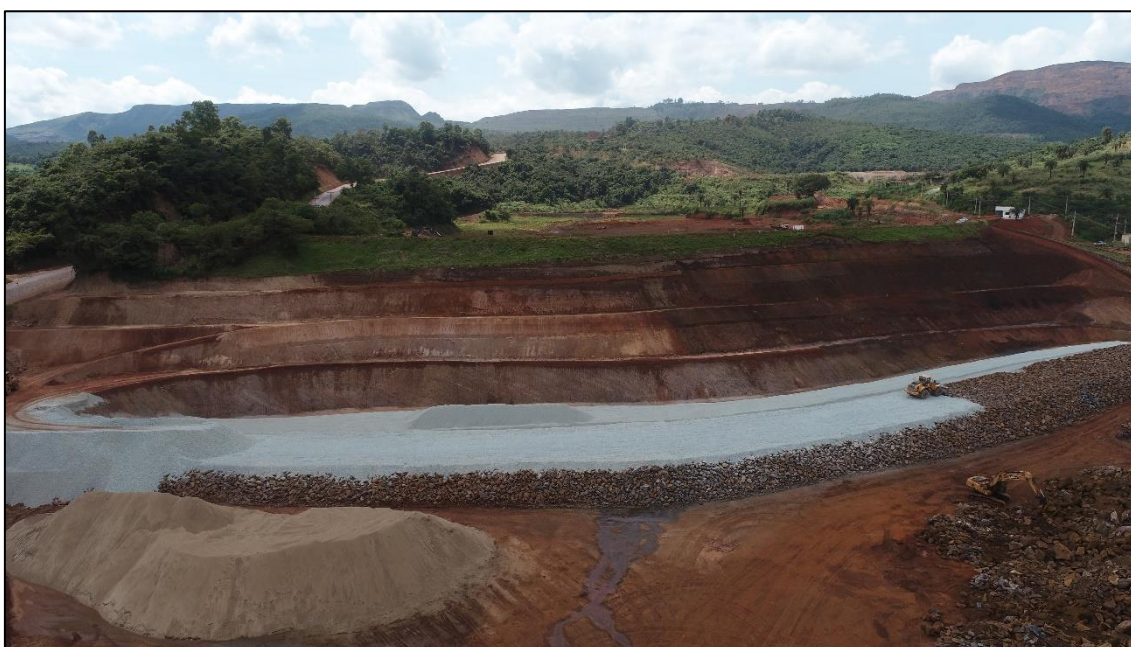
Figura 15 – Vista frontal dos taludes de jusante, notar avanço do tapete drenante no intervalo no mês de fevereiro.
