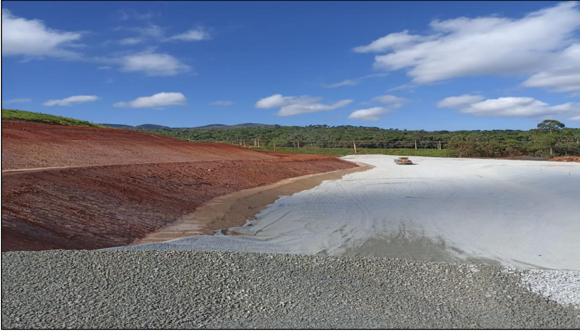
Figura 16 – Vista aproximada dos taludes de jusante e tapete drenante, notar transição de areia grossa, brita 0 e 2. Registro em março de 2022.
