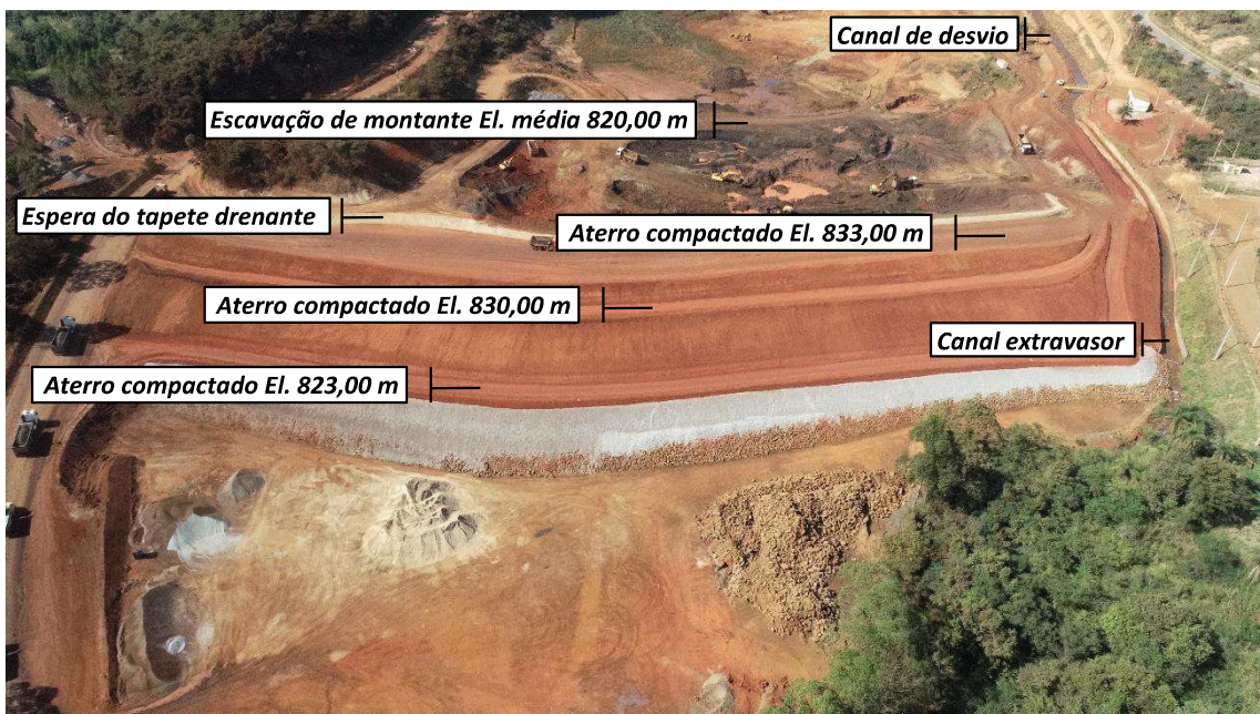
Figura 19 – Vista geral da estrutura, notar avanço do processo de descaracterização e adequação. Registro em julho de 2022.
