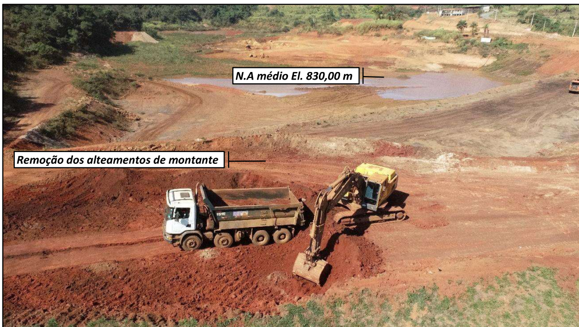
Figura 15 – Vista de montante da bacia de acumulação, notar N.A abaixo do previsto em projeto e remoção dos alteamentos de montante. Registro em junho de 2022.
